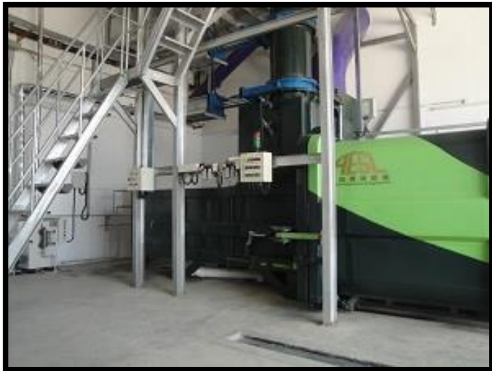
垃圾房內設的固定壓縮機 Fixed compactor in refuse room
